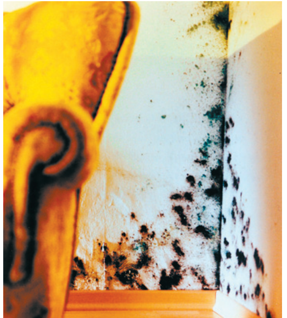
Nicht immer ist die Ursache für Beschwerden so leicht zu entdecken wie in dieser Ecke.
